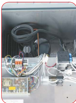
Servicefreundlicher Zugang für Anschlussarbeiten und Wartung
